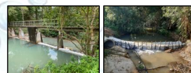
ฝายชะลอน้ำคลองมะเดื่อหวาน และ คลองบ้านค่าย
